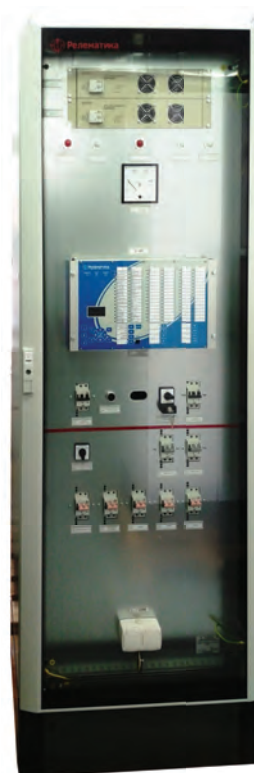
Шкаф ОБР и управления разъединителями с питанием цепей ОБР
